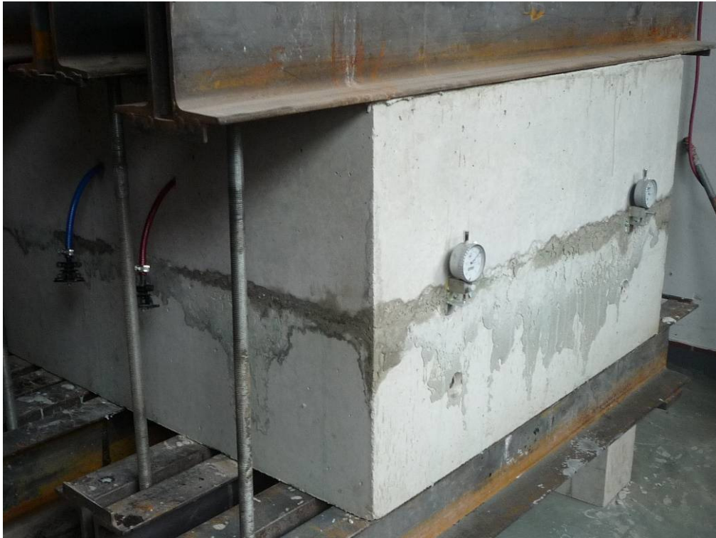
Bild 4: Prüfbehälter bei einem Wasserdruck von 0,4 bar –Feuchtestellen
